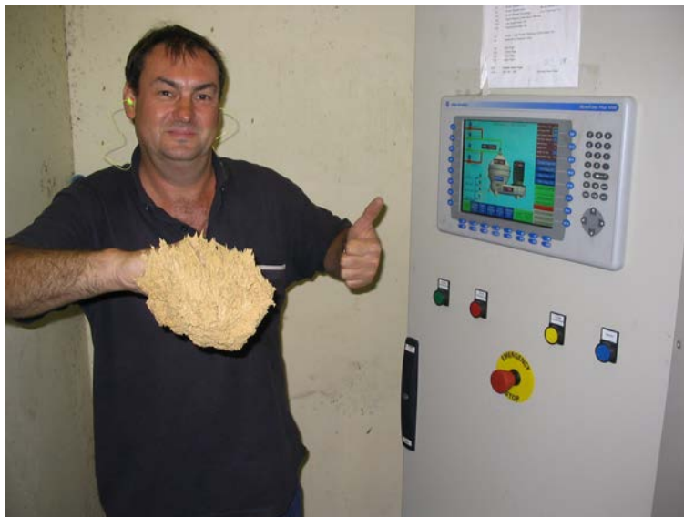
Systeme de contrôle à DISTELL GROUP-Bergkelder, Stellenbosch, Afrique du Sud
